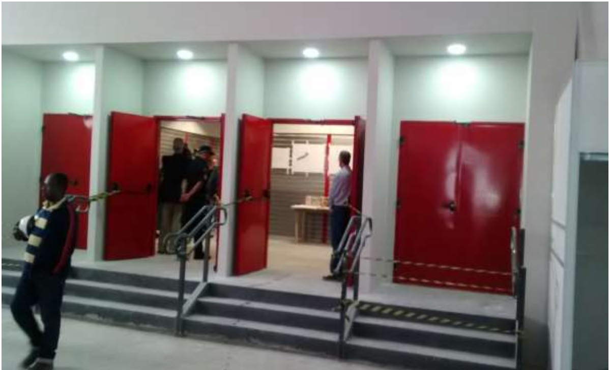
Vista de portas corta-fogo na passagem da “tenda” na área externa para a edificação.
