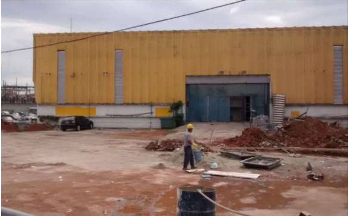
Vista da entrada do Amarelão pela Avenida do Estado, obras em finalização.
