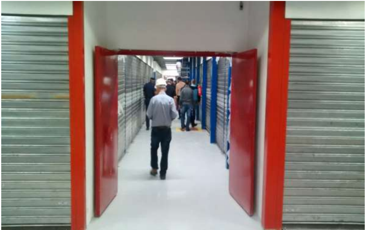
Vista de porta corta-fogo entre setores internos da edificação no piso térreo.
