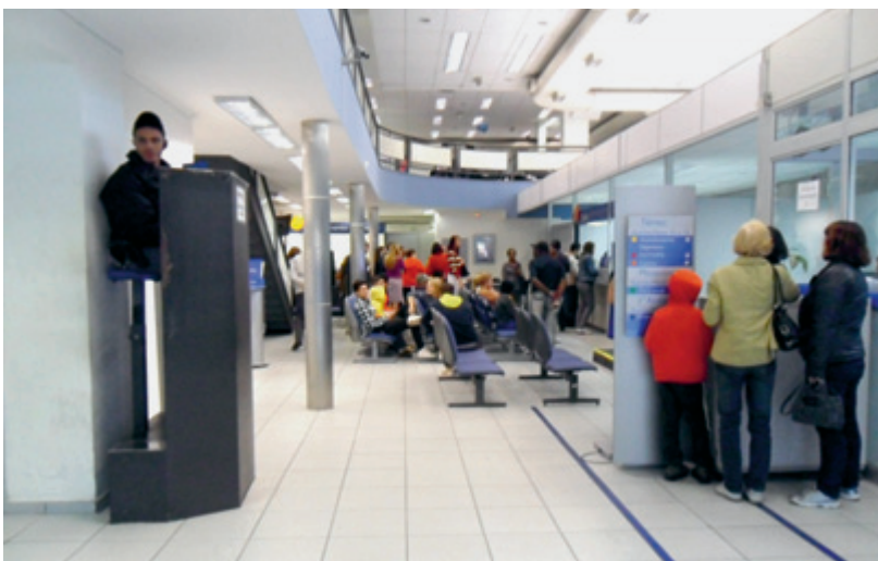
Foto 04: Vista da falta de sinalização tátil de piso no interior da mesma agência bancária
