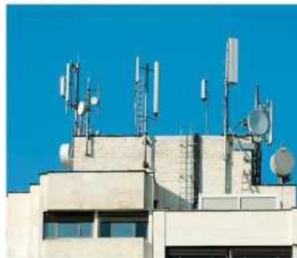
ERB em topo de prédio (Rooftop)
