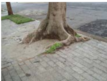
Fig. 20 - Errado: Sufocamento da raiz, impermeabilização e futuros problemas com quebra de calçada
