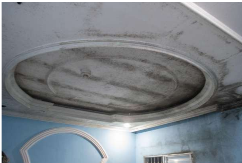
Figura 2: mofo no teto de quarto
