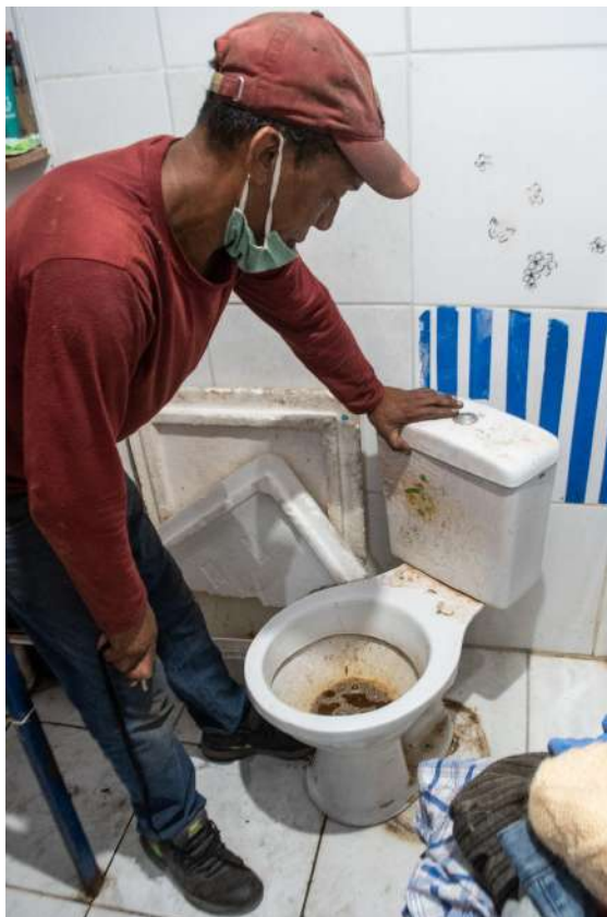
Figura 9: privada quebrada e entupida
