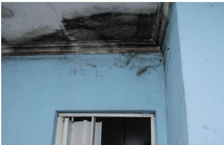
Figura 1: mofo no teto de quarto
