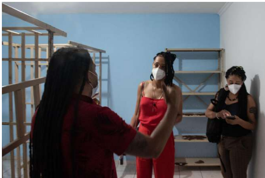
Figura 5: Um dos quartos que está vazio. Detalhe para prateleira ao fundo enferrujada
