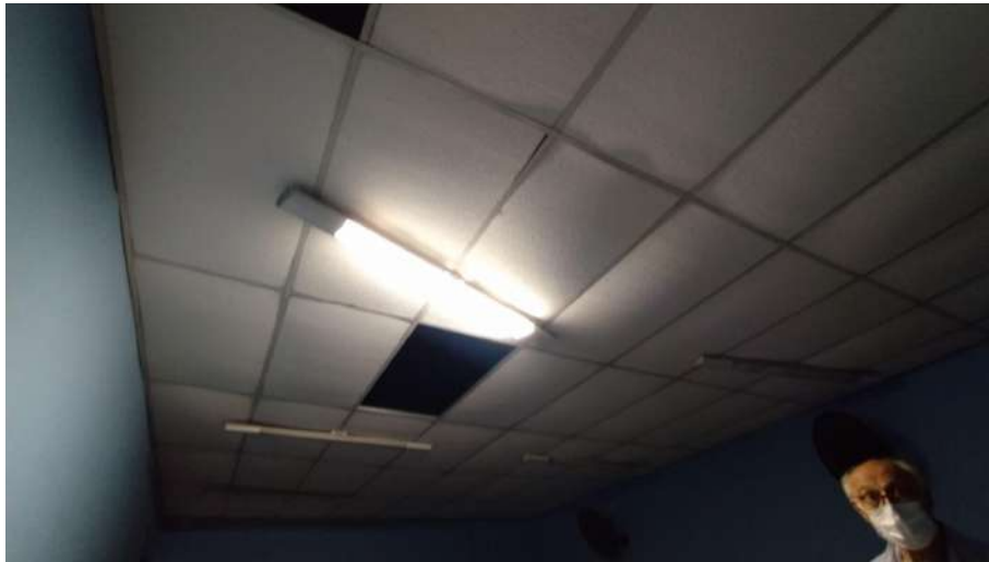
Figura 22: refeitório - detalhe das luzes queimadas
