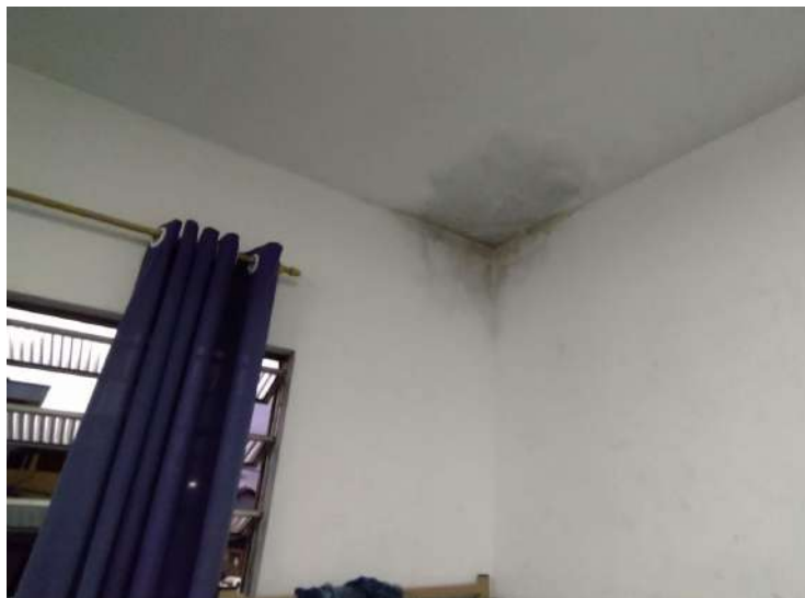
Figura 4: infiltração no teto de um quarto no 1° andar
