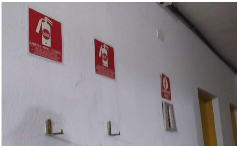
Figura 5: ausência de extintores em espaço apropriado a eles
