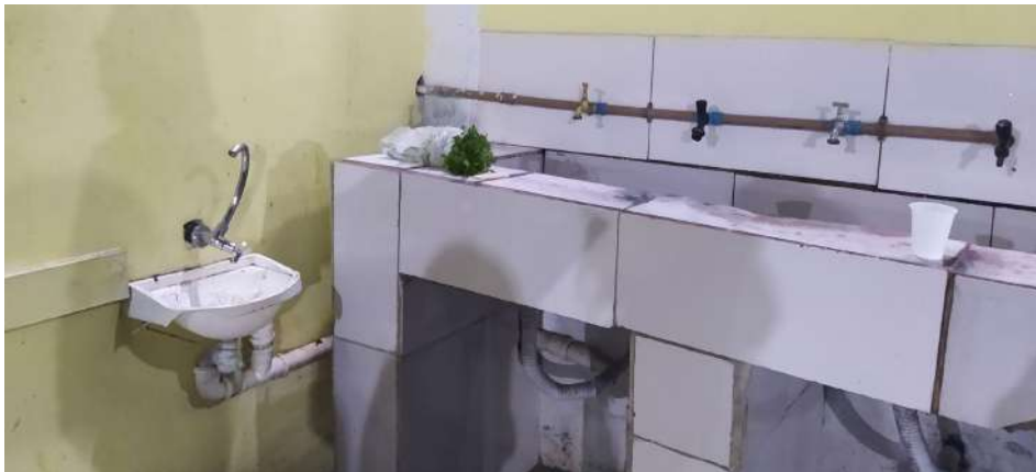
Figura 23: 3 pias no refeitório, sendo a da esquerda com água potável
