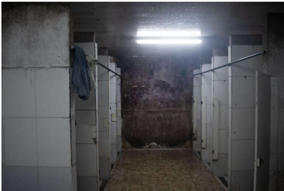
Figura 10: chuveiros masculinos sem porto e com mofo na parede
