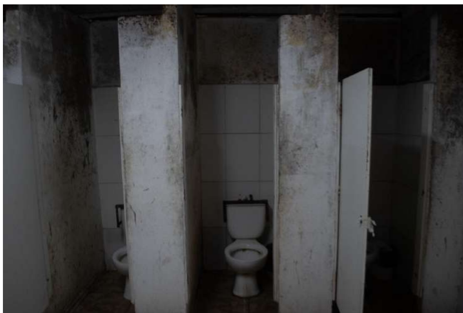
Figura 9: banheiro masculino com mofo nas paredes e sem assento nas privadas
