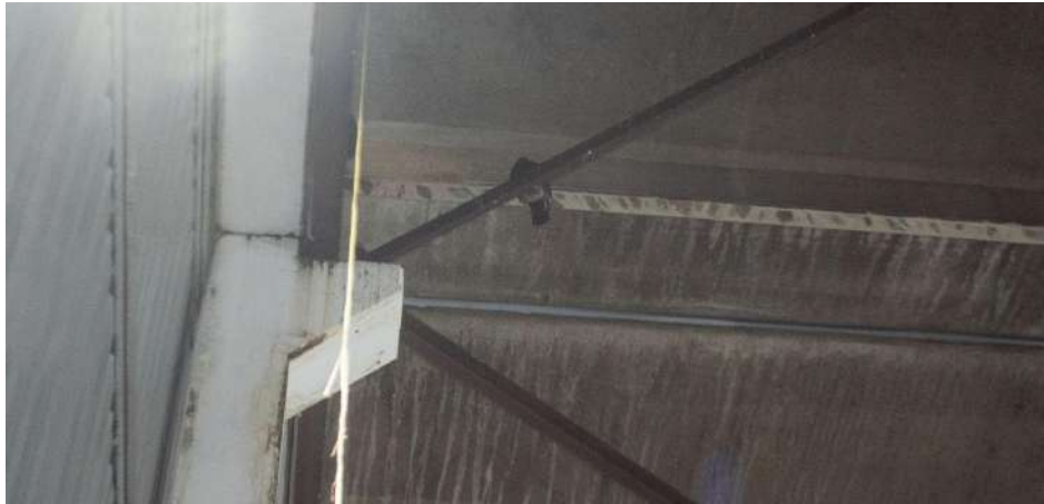
Figura 22: detalhe do telhado sem forro e com pombos
