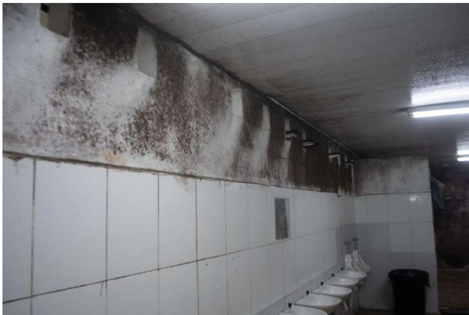
Figura 8: banheiro masculino com mofo nas paredes
