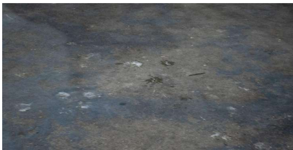
Figura 21: detalhe das fezes de pombos no refeitório
