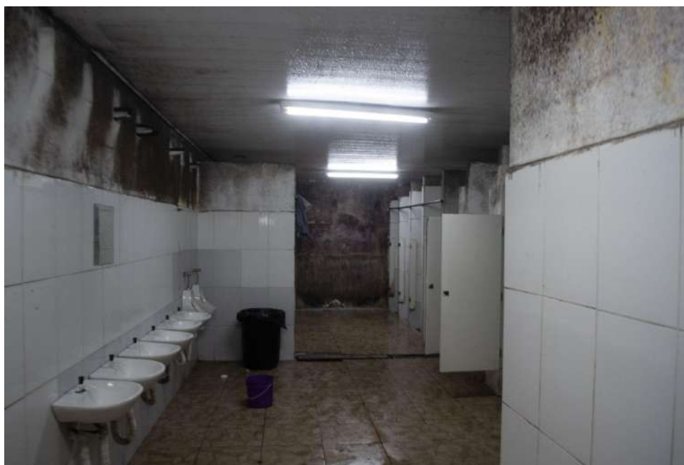
Figura 7: banheiro masculino com mofo nas paredes
