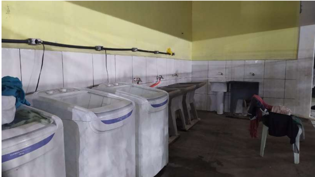
Figura 20: lavanderia - máquinas e tanques
