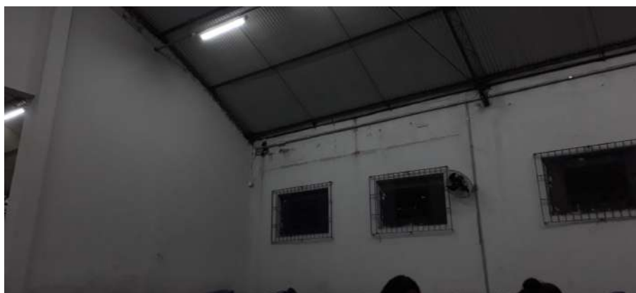
Figura 7: mancha de possível infiltração
