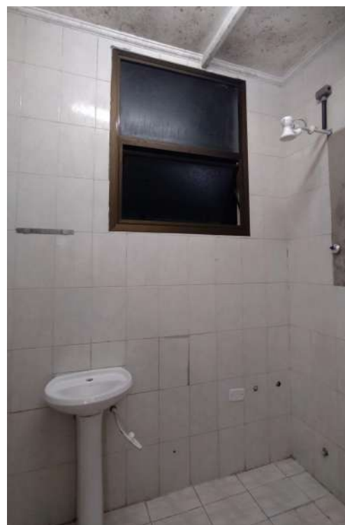
Figura 13: banheiro - 1º andar, pia sem torneira
