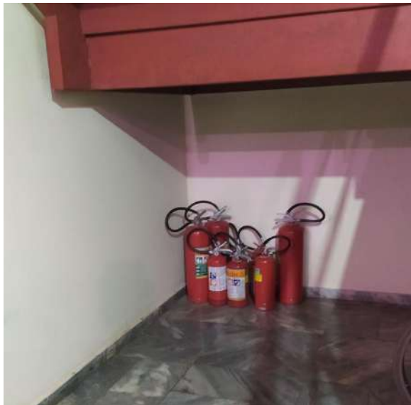
Figura 3: extintores no térreo do prédio principal
