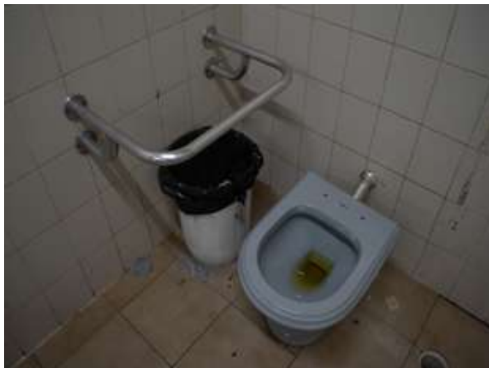
Figura 9: banheiro para PCD - detalhe do vaso sanitário sem assento
