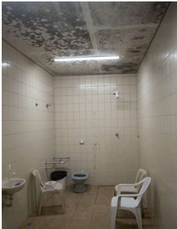
Figura 8: banheiro para PCD, sem assento no vaso sanitário, sem barra nas paredes do chuveiro e com mofo no teto
