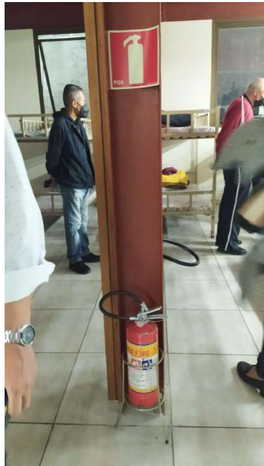
Figura 4: extintor no quarto
