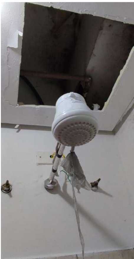
Figura 6: ausência de forro em um banheiro
