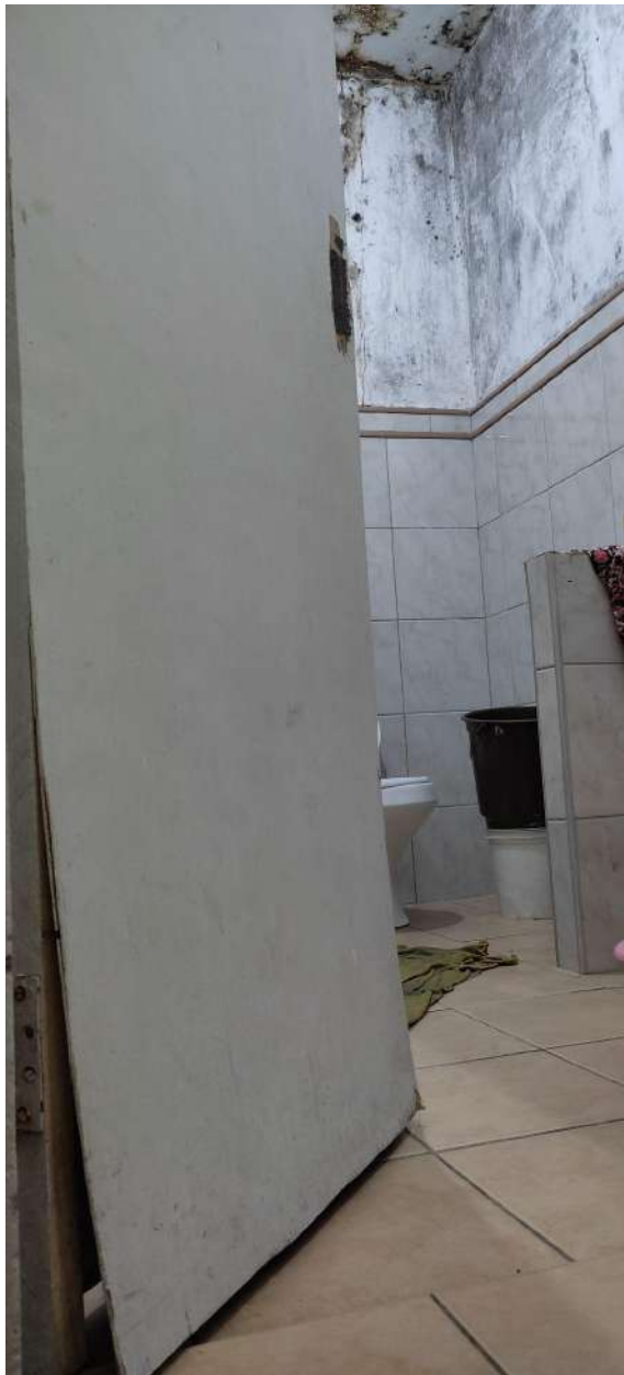
Figura 8: porta com acabamento solto e mofo do banheiro
