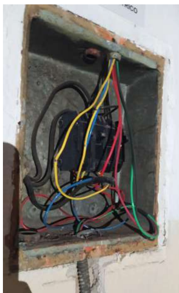
Figura 2: quadro elétrico exposto (6º andar)
