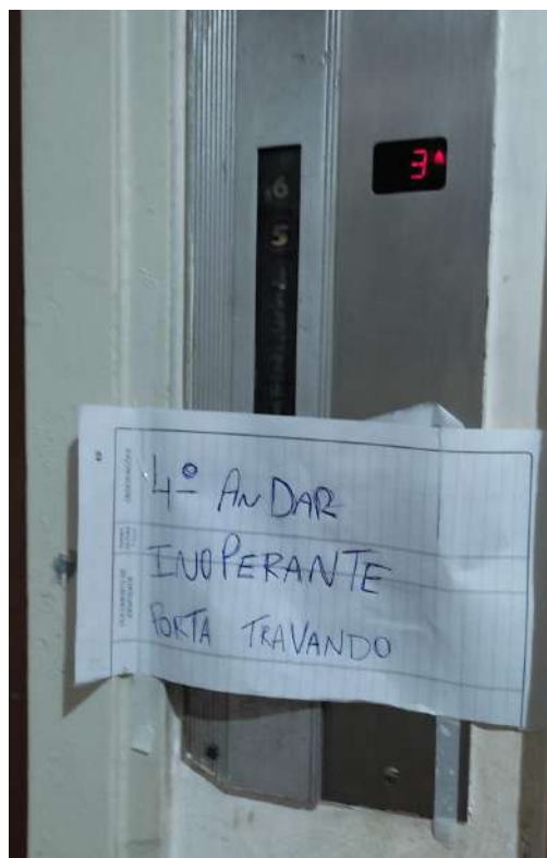
Figura 18: 4º andar inoperante (elevador em funcionamento)
