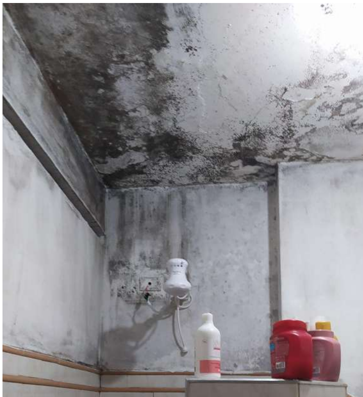
Figura 10: mofo no teto do banheiro
